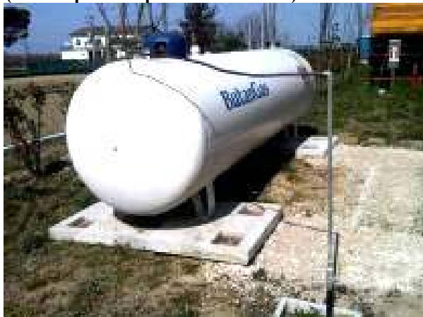
Foto 2 – Serbatoio GPL (uso temporaneo per riscaldamento)
