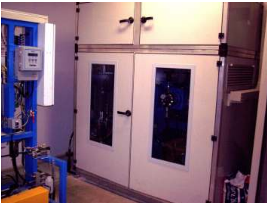
Foto 1 – Cabina pompa pentano 9010 dotata di estrattori d'aria e rilevatore
