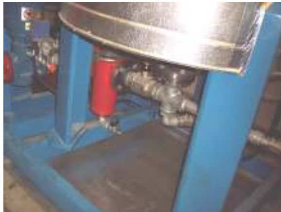
Foto 11 – Vassoi estraibili in acciaio inox contenimento perdite accidentali serbatoi intermedi poliolo e isocianato
