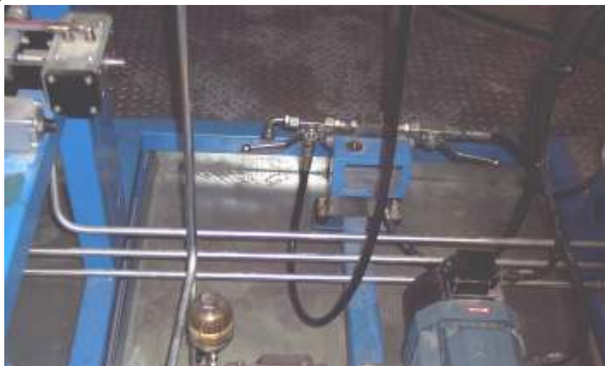
Foto 12 – Vassoi estraibili in acciaio inox contenimento perdite accidentali serbatoi intermedi catalizzatore
