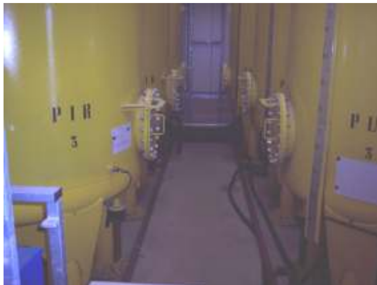
Foto 6 – Particolare dei 6 serbatoi verticali del poliolo
