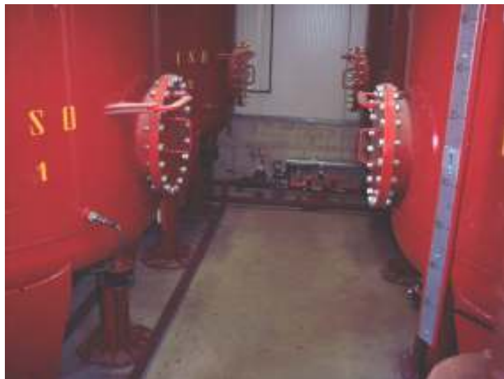
Foto 4 – Particolare dei 4 serbatoio verticali del polimetilen polifenil isocianato
