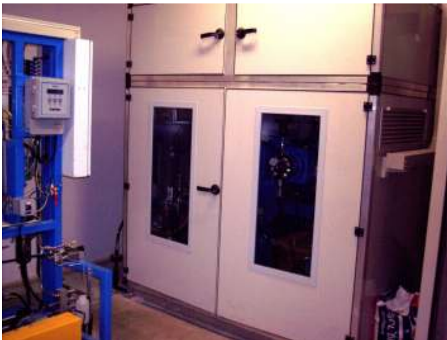
Foto 1 – Cabina pompa pentano 9010 dotata di estrattori d'aria e rilevatore
