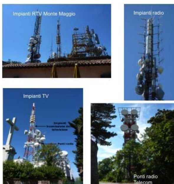
Figura 3 - Impianti presenti presso un sito in provincia di Forlì-Cesena (Monte Maggio)
