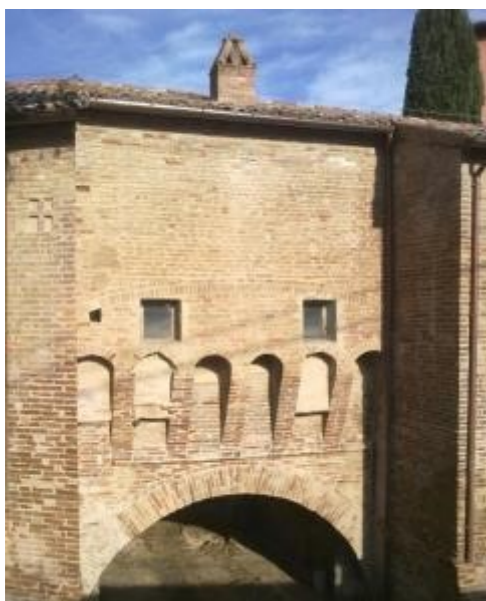
Figura 133 - Portaccia, per la quale l'Amministrazione Comunale nel 2015 ha ripristinato la copertura e la muratura esterna
